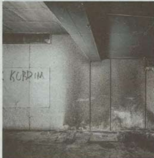
Bizarre Hinterlassenschaft eines Feuers in der Unterführung Neue Straße. Foto: Matthias Kessler
